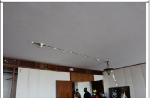
Salão Nobre com forro depredado
