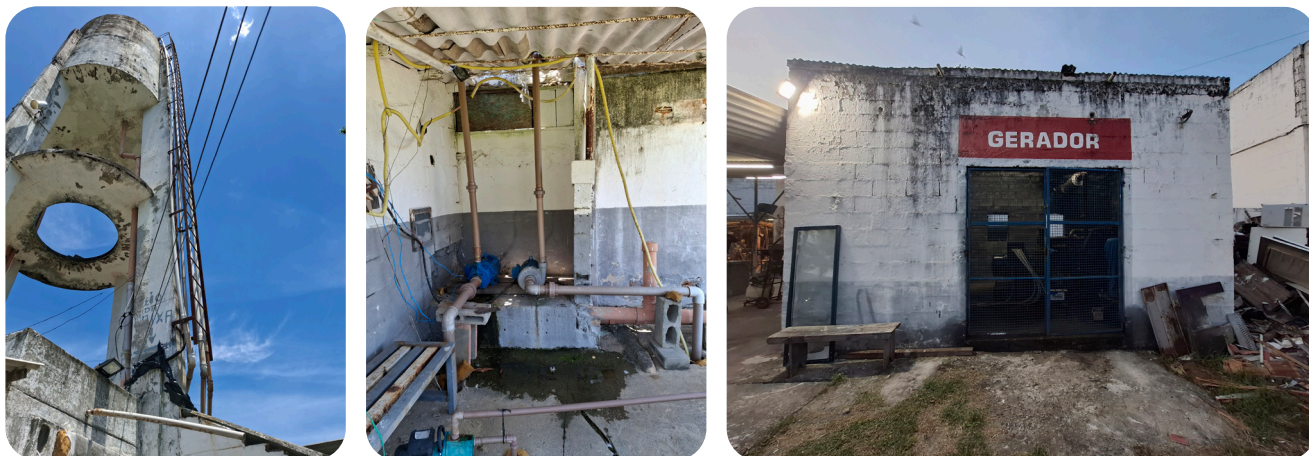
Figura 15: Estrutura da torre de água muito precária, com instalações quebradas e expostas
